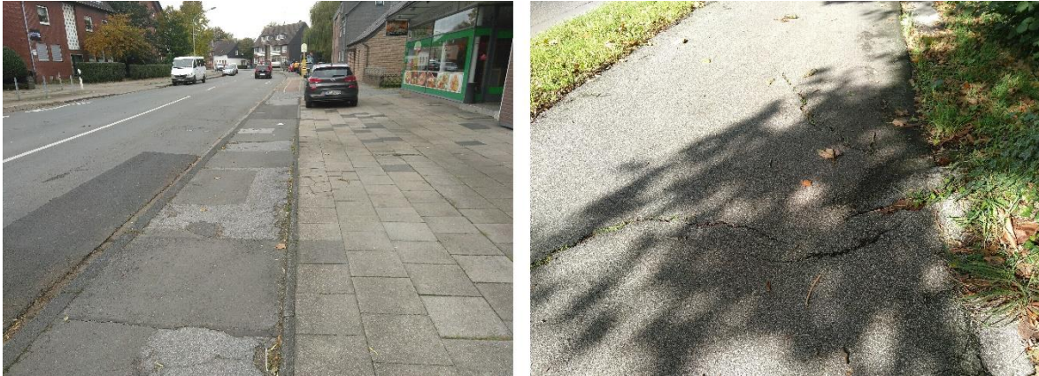
Abbildung 10: Beispiele für einen sehr schlechten Zustand durch Risse oder Löcher (Eigene Aufnahmen)
